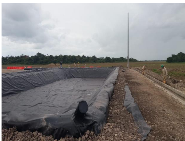
Fotografía 2-10 Piscina de almacenamiento de agua
