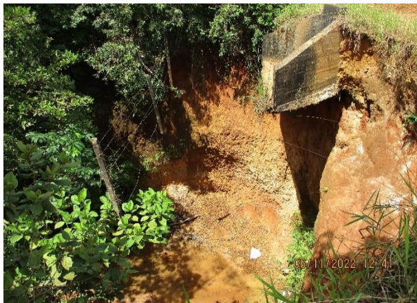
Fotografía 3.2.1-11 Vista panorámica de deslizamiento de suelos a borde de carretera en la vereda Yurimena, Puerto López
