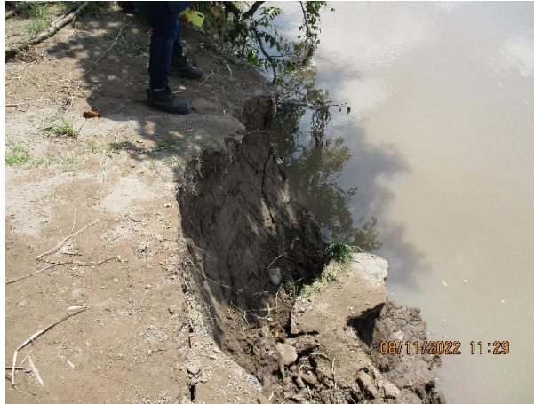
Fotografía 3.2.2-7 Socavación lateral en márgenes del río Humea, vereda San Isidro, Cabuyaro
