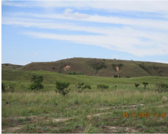
Fotografía 3.2.2-8 Vista panorámica de deslizamiento de tierra en laderas inclinadas de la Formación Guayabo Miembro Superior – intervalo arcilloso, vereda Yucao – Matazul, Puerto López
