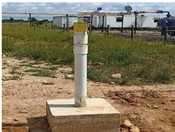
Fotografía 3.2.7-8 Pozo de observación Indico 3, vereda El Vergel, Municipio de Cabuyaro
