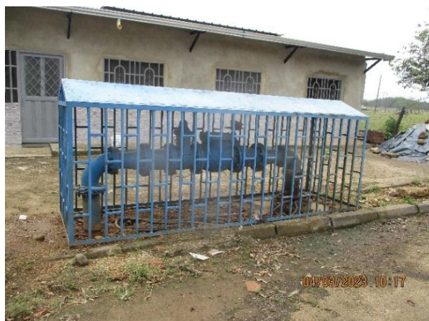
Fotografía 3.2.7-1 Pozo P-259 Acueducto Municipal, casco urbano de Puerto López
