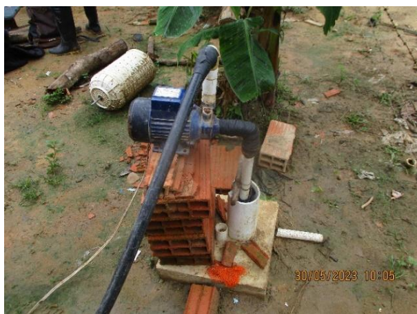
Fotografía 3.2.7-2 Pozo P-327 en PVC, predio Los Limoncitos, Vereda El Vergel
