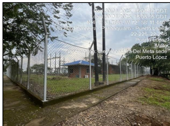
Fotografía 3.4.3-17 Subestación eléctrica de Puerto López
