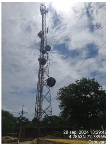
Fotografía 3.4.3-4 Antena de telefonía móvil E 5023337,91506 N 2031636,95064 Fuente; Gessig 2024
