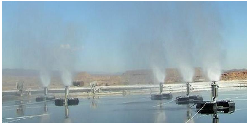
Figura 4.3-97 Evaporador mecánico en funcionamiento.
