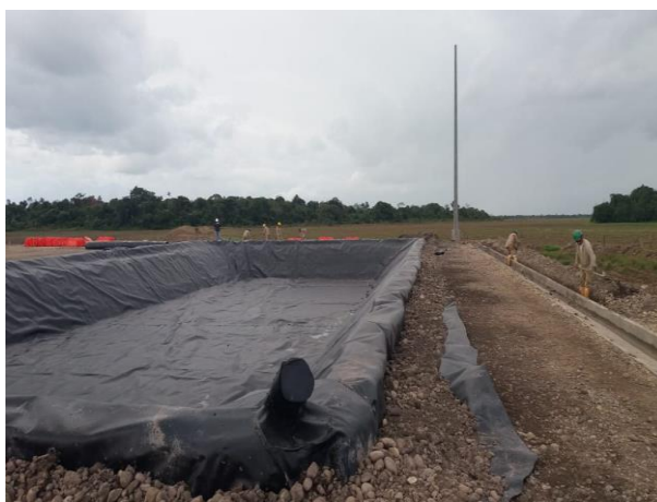
Fotografía 2-10 Piscina de almacenamiento de agua
