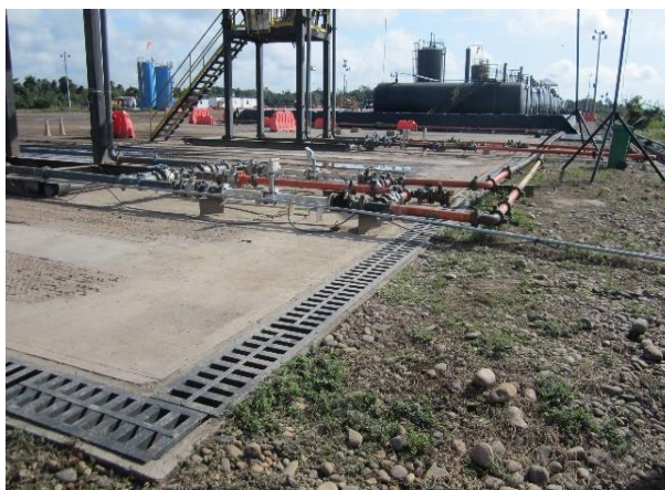
Fotografía 2-6 Cuneta agua aceitosa - cárcamo
